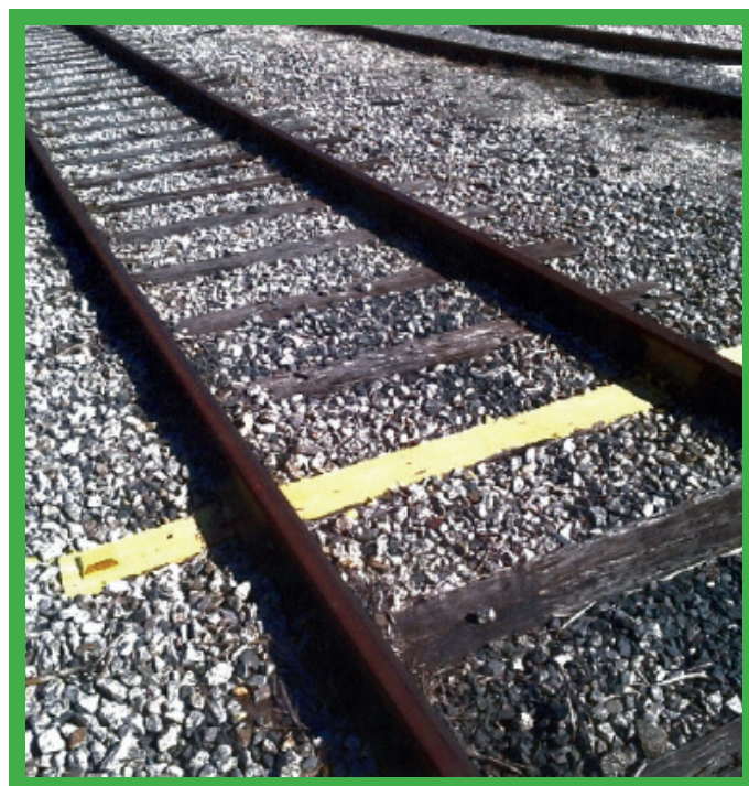
Značky na jasnú identifikáciu požadovanej polohy pristavenia zaparkovaných vagónov
