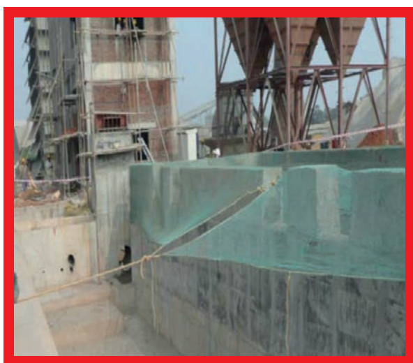
Smrteľná nehoda v roku 2011: Konštrukčný projekt: dodávateľ spadol pri prekračovaní múru počas budovania nadstavby.
