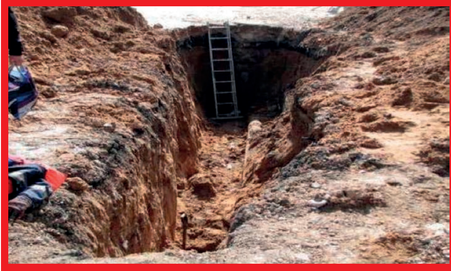
Smrteľná nehoda v roku 2009: Výkop (2,1 m) bez akéhokoľvek podopretia/akýchkoľvek podpier sa zrútil.
