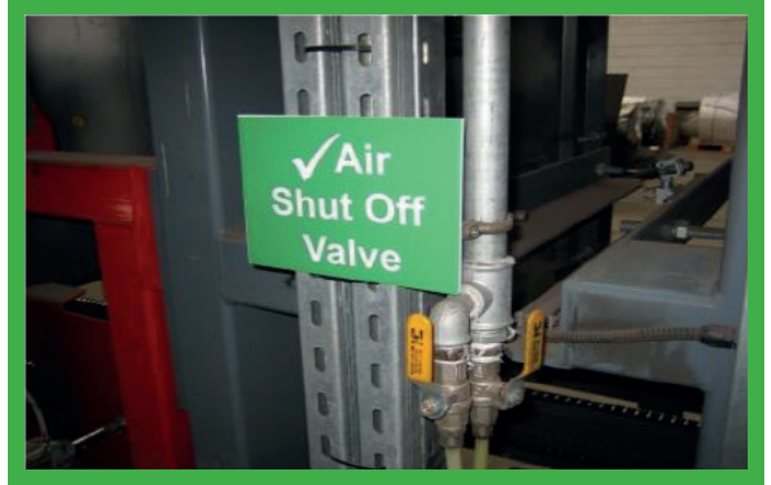
Jasne identifikovaný bod odpojenia a zaistenia pneumatickej energie.
