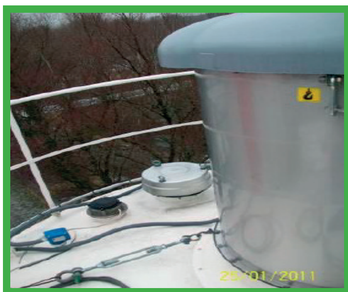
Posledný článok ochrany: Filter upevnený ku konštrukcii sila.
