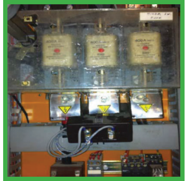
Alle spannungsführenden Berührungspunkte ummantelt und überzogen.
