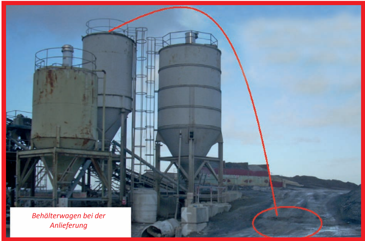
Vorfall – Beinahunfall 2019: Filter wurde in anliegenden Bereich geschleudert
