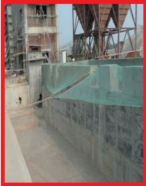
Tödlicher Unfall 2011: Auftragnehmer stürzt, als er eine Wand beim Bau eines Ausbaus passiert.
