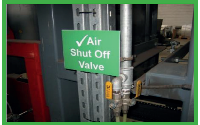
Eindeutig identifizierte pneumatische Trennstelle.
