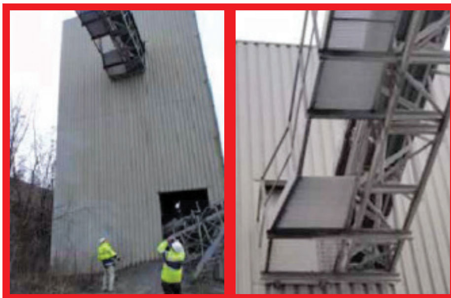
Tödlicher Unfall (Nicht-CRH-Standort): Arbeiter stürzt 14 m tief, als ein Profil eines Laufstegs nachgibt. Die Befestigungsbolzen hatten sich im Laufe der Zeit durch das nahegelegene Schüttelsieb gelöst.
