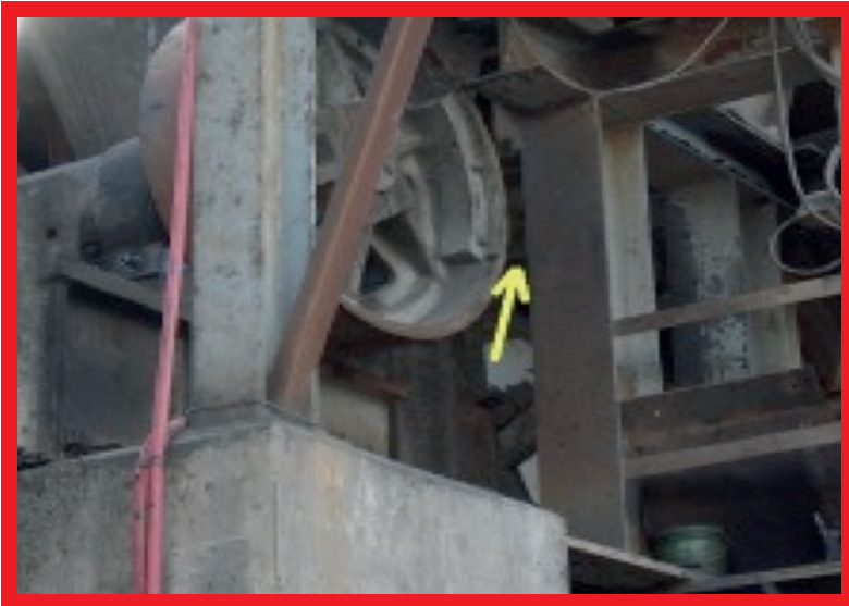
Tödlicher Unfall innerhalb der Gruppe – Fallstudie 2006: Während eines Hebevorgangs wird ein Vorarbeiter zwischen der angehobenen Last und einem Stahlträger eingeklemmt.
