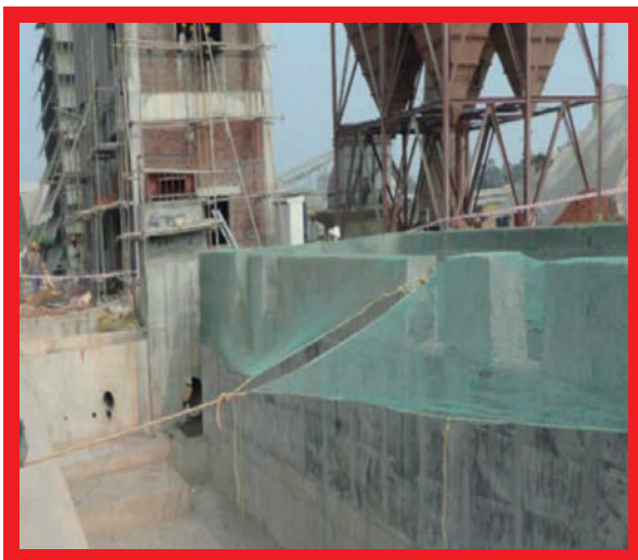
Tödlicher Unfall 2011: Bauprojekt: Subunternehmer stürzt beim Bau einer Erweiterung bei Überquerung einer Mauer ab.
