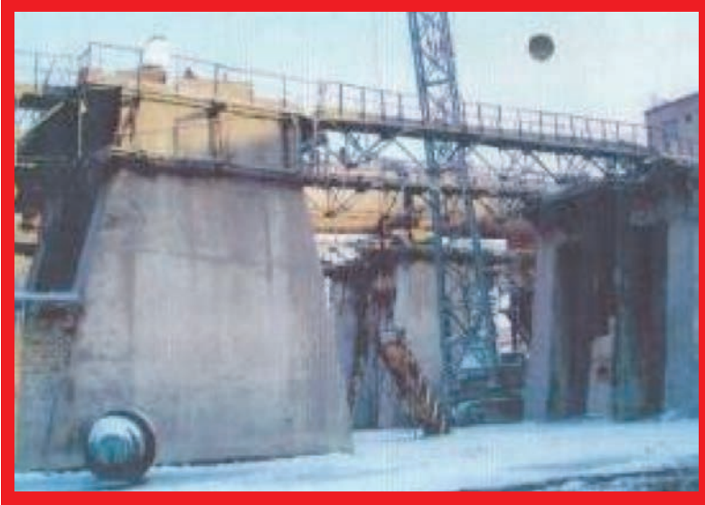
Tödlicher Unfall innerhalb der Gruppe – Fallstudie 2005: Subunternehmer fällt vom Laufsteg, als dieser angehoben wird.
