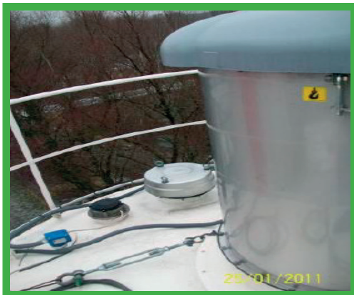
Letztes Sicherheitsmittel: Filter an die Silostruktur gekettet.
